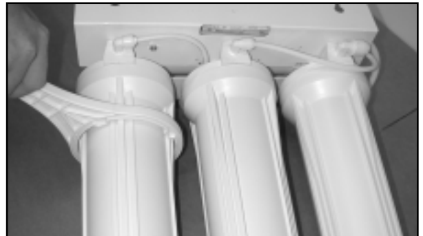
Figure 11 - Usage de la clé à carter pour le remplacement des cartouches à filtre.
