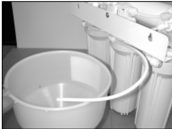
Figure 10 - Faites écouler l'eau de rinçage et les granules de charbon dans un contenant
